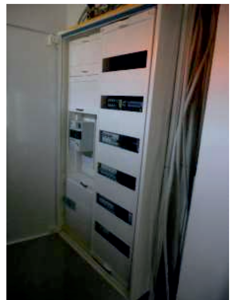
Neuer Elektroverteilerkasten (unten)
